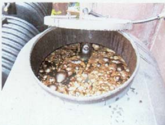
Fig. 1 Biomasse i sandfang-delen ved innløpet i avskilleren
