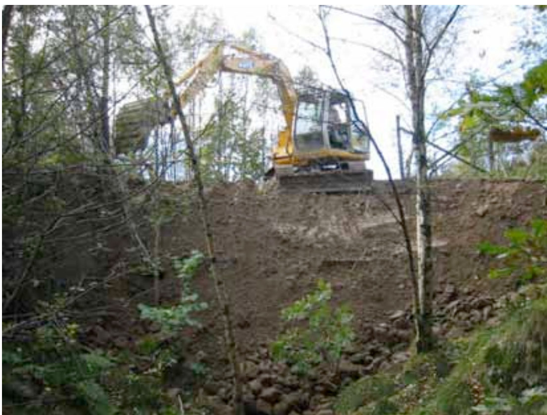
Figur 1. Lyngdal planteskole, Vindskaret 16.09.03. Tildekking av deponert DDT-slam i bakkant av det nedlagde grustaket.
