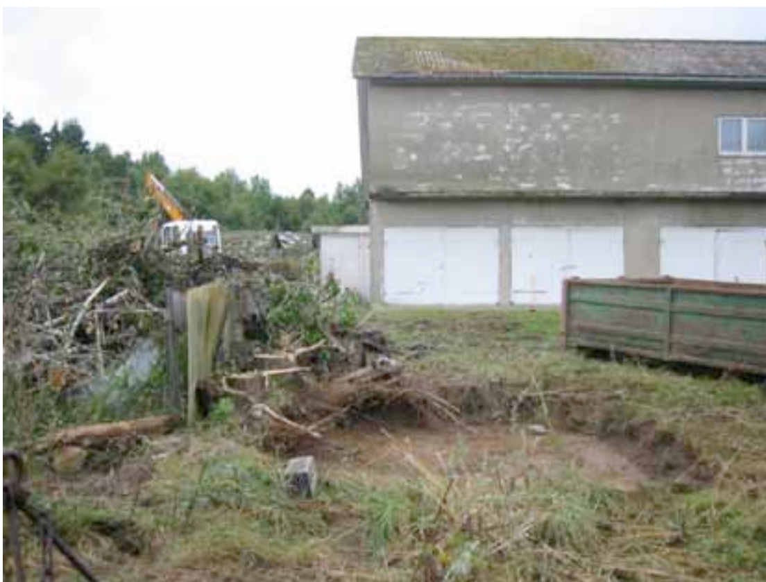
Figur 1. Tidlegare Kråketorp planteskole 21.08.03. Massefjerning frå lagerstaden for behandla planter med avrenning av overskotsvæske.
