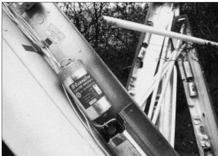
Lysrørarmatur med kondensator som inneholder PCB.
