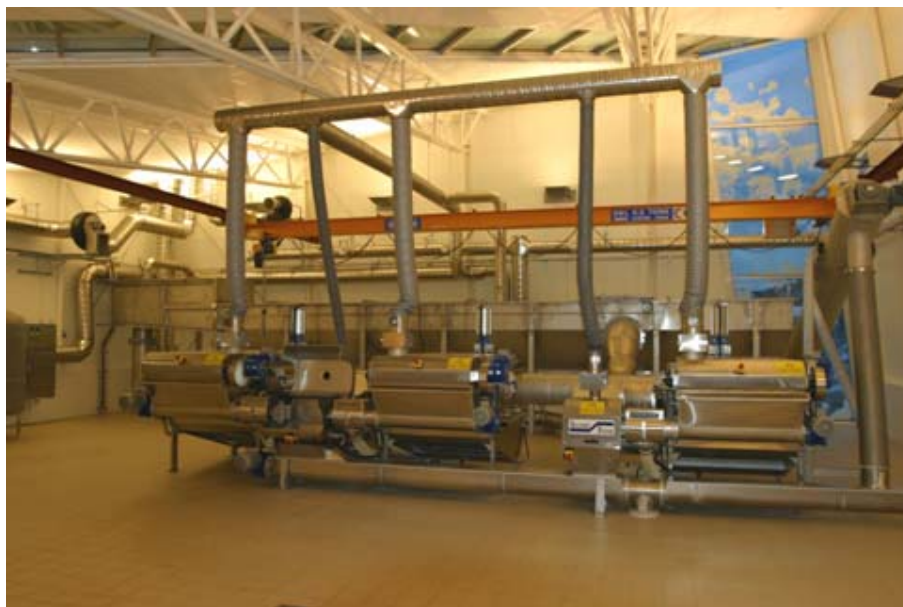
Fig. 2. Breivika renseanlegg med tre silmaskiner av typen Salsnes filter.
