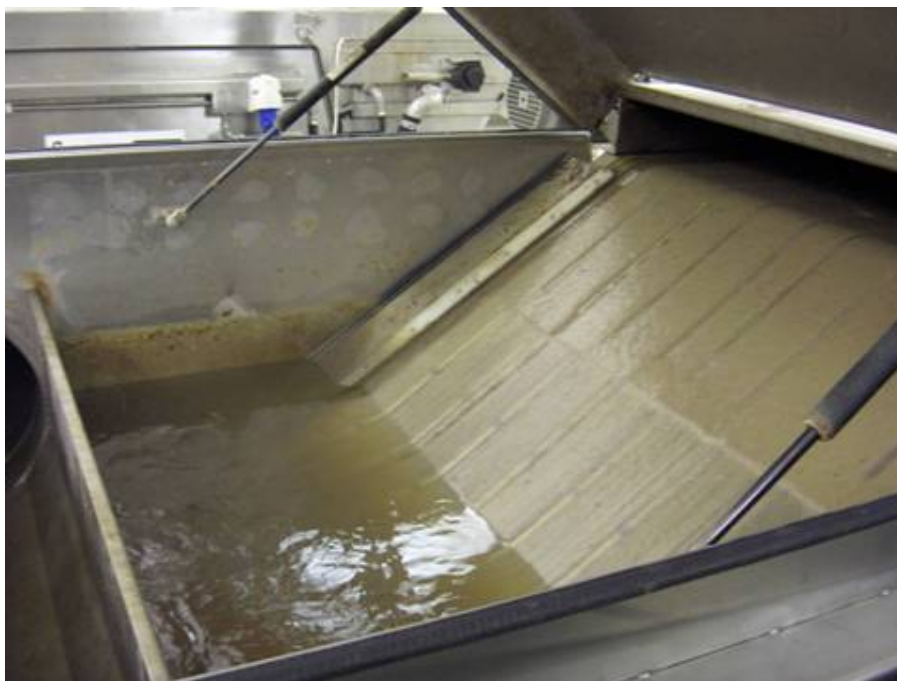
Fig.6. Figuren viser filtermatte som er bygd opp under statisk siling på Breivika renseanlegg.
