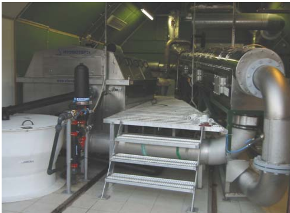
Fig. 3. Forsøksanlegget på Selnes med MaskoZoll og Hydrotech.
