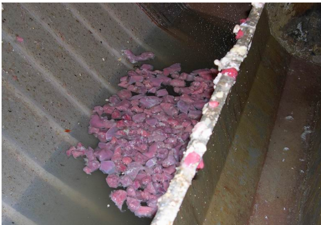
Figur 27. Innløpskasse på sil 2 på Sirevåg renseanlegg.
