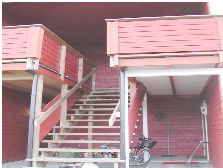
Bilde 3 Eksempel på uheldig plassering av åpen trapp.
