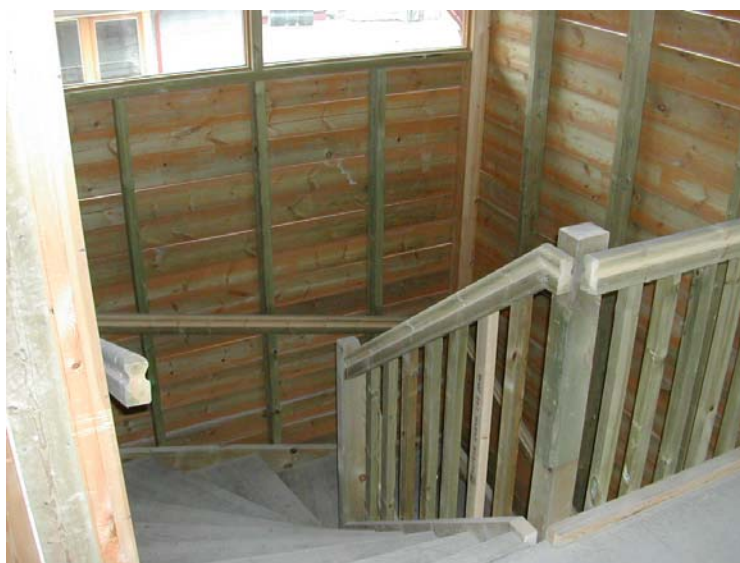
Bilde 4 Eksempel på avvik fra REN – feil materialvalg og feil utført beskyttelse av trappenedløp i bygning med 3 etasjer.
