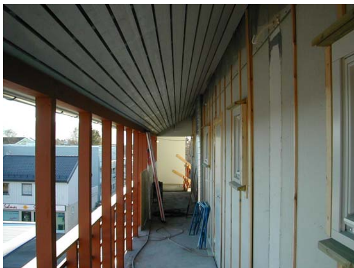
Bilde 2 Eksempel på feil utførelse av tak i forhold til REN.
