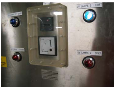
Figur 3.3.6: Kontrollskap for UV-anlegg. Signallys viser om UV-lampene lyser, timetelleren (sort) angir hvor lenge anlegget har vært i drift, og intensitetsmåleren (hvit) viser lysintensiteten inne i UV-kammeret (Foto: Folkehelseinstituttet v/Eyvind Andersen).
