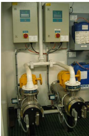
Figur 3.3.5: UV-anlegget på bildet består av to bestrålingskamre som begge er utstyrt med UV-sensor på siden og manuell renseanordning foran. Øverst på bildet er kontrollskapene (Foto: Folkehelseinstituttet v/Bjørn Løfsgaard).
